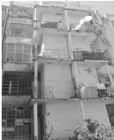
Figura 3 – Edifício em ruínas na Penha de França.
